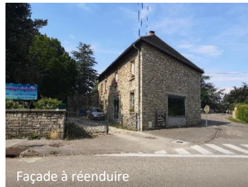
Façade à réenduire
